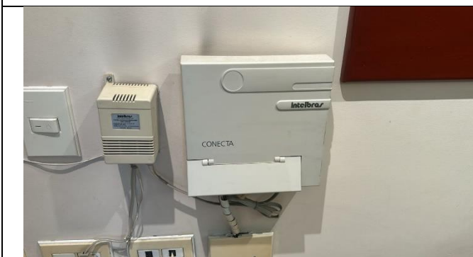
Pabx conecta, marca Intelbras
