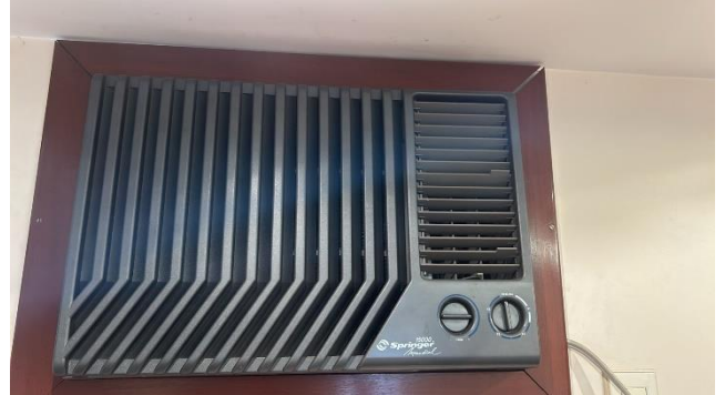
ar condicionado marca Springer 1500
